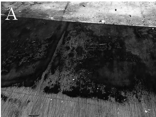
図6 タイルカーペット下地ベニアに発生したカビ (表3 A)
