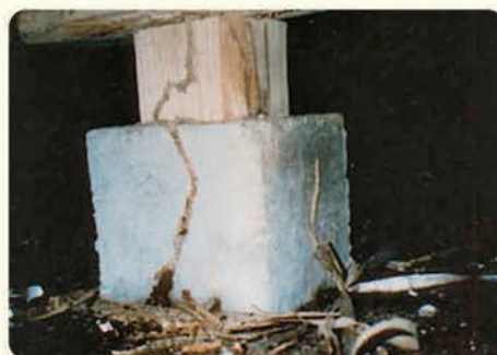
地面から床下へ続いている虫の通路、細かい土でできている。
