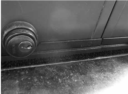
図8 鍵穴に合わせてフレームをカットして取り付けた施工例
