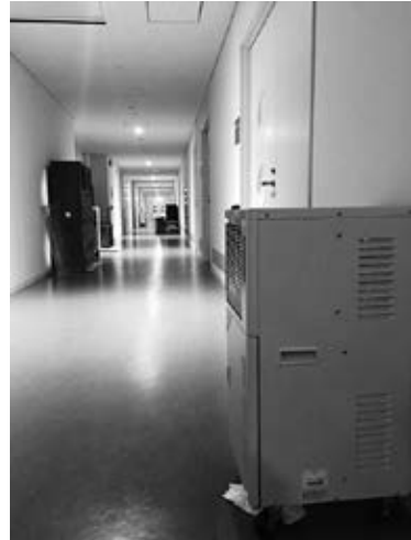
1階廊下に設置した除湿機
