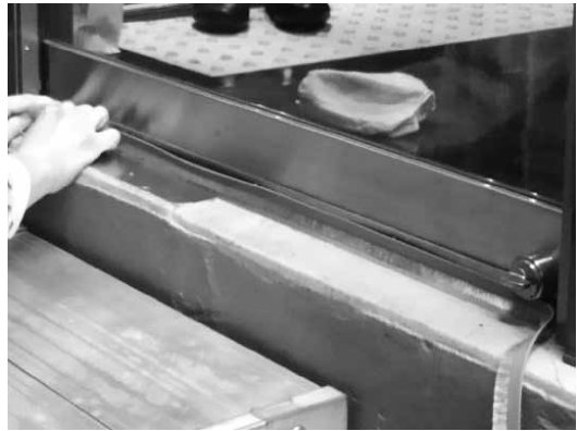
写真3 ガラス戸の下にブラシを取り付け、外部からの侵入を防ぐ
