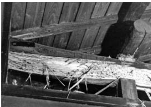
写真5 イエシロアリによる木造建築物の梁材の被害
