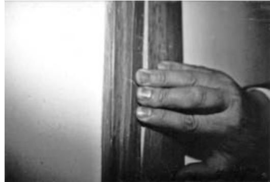
写真9 シロアリに内部だけをひどく食害された柱(強く押すとこのようにへこむ)
